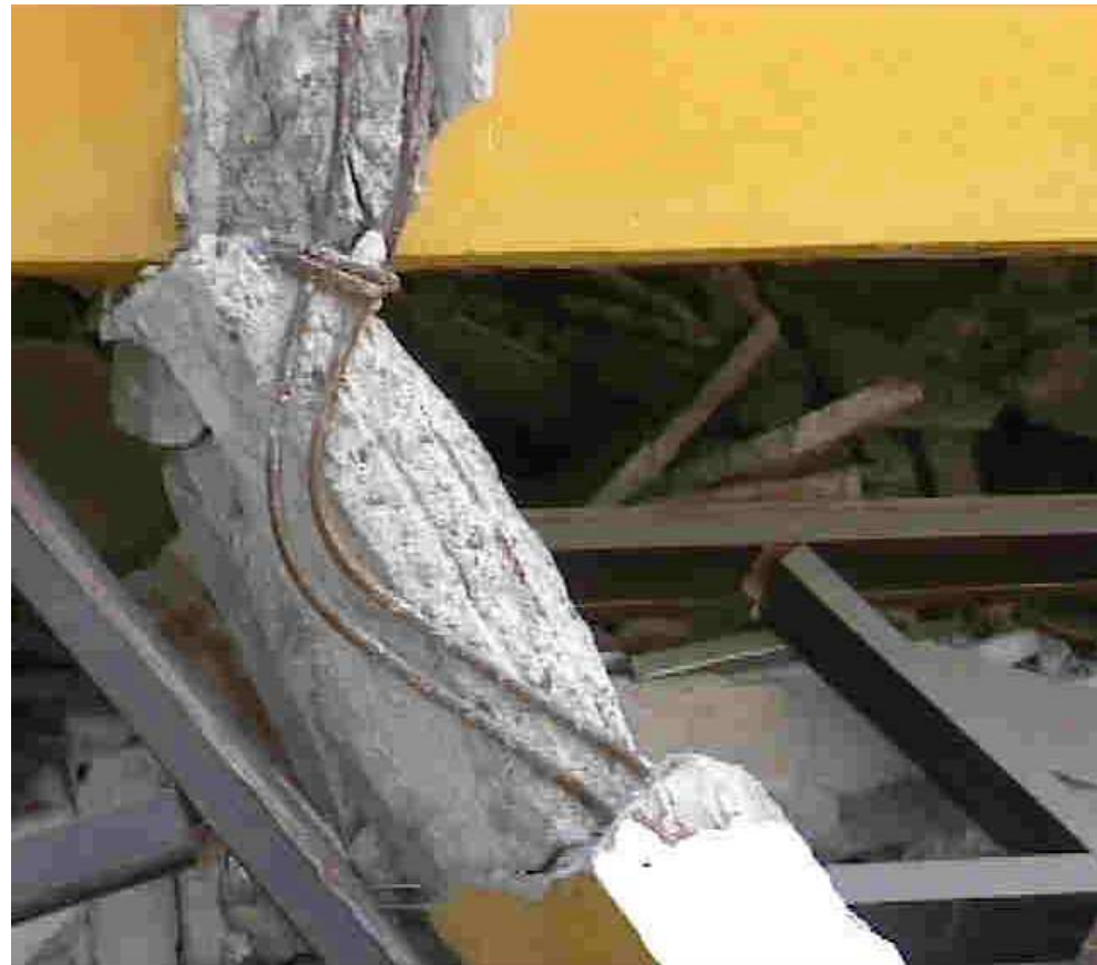
Stâlp zvelt, ancorare insuficientă a armăturilor și absența etrierilor
