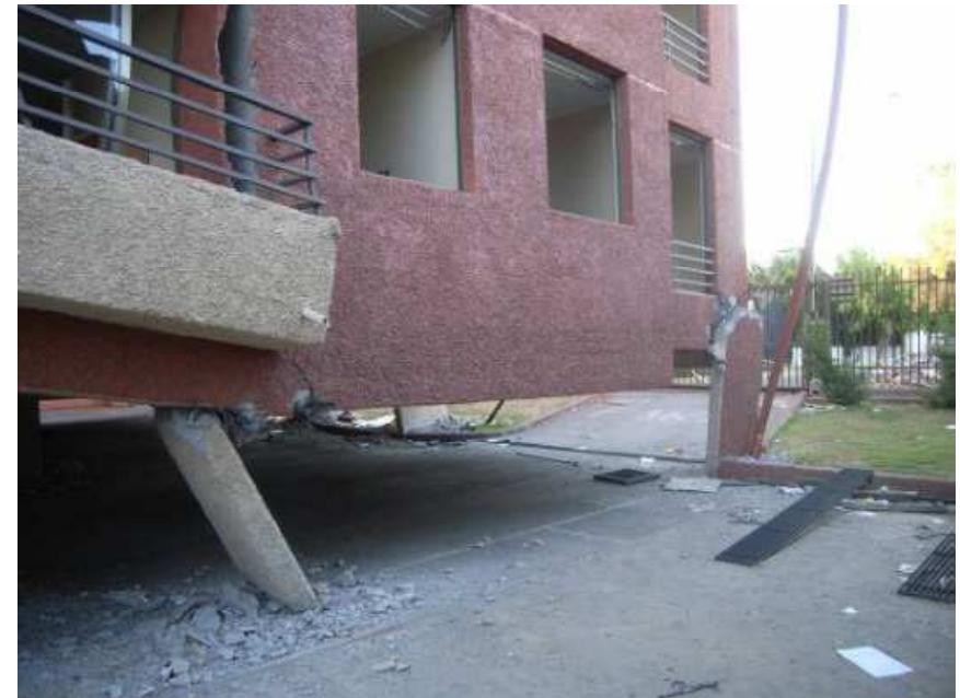
Colapsul parterului flexibil
