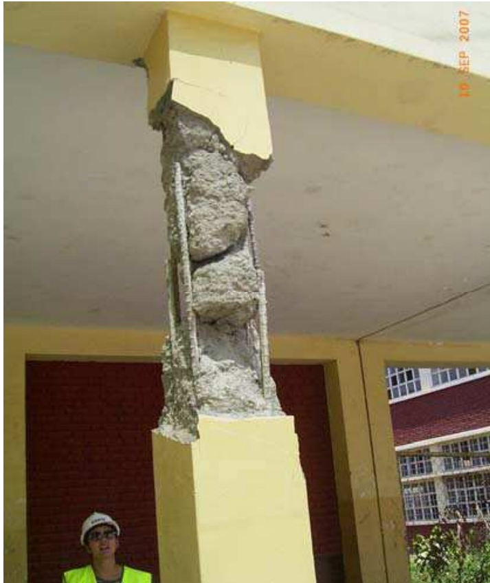
Cedarea stâlpului la tăiere datorită lipsei etrierilor și calității reduse a betonului
