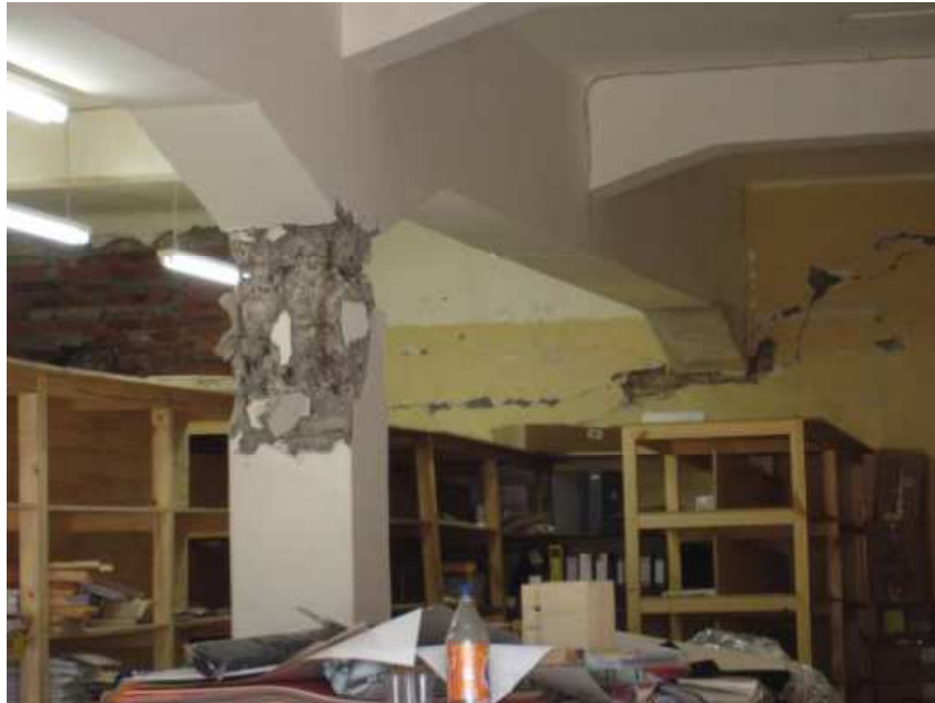
Armare insuficientă la tăiere și calitate redusă a betonului
