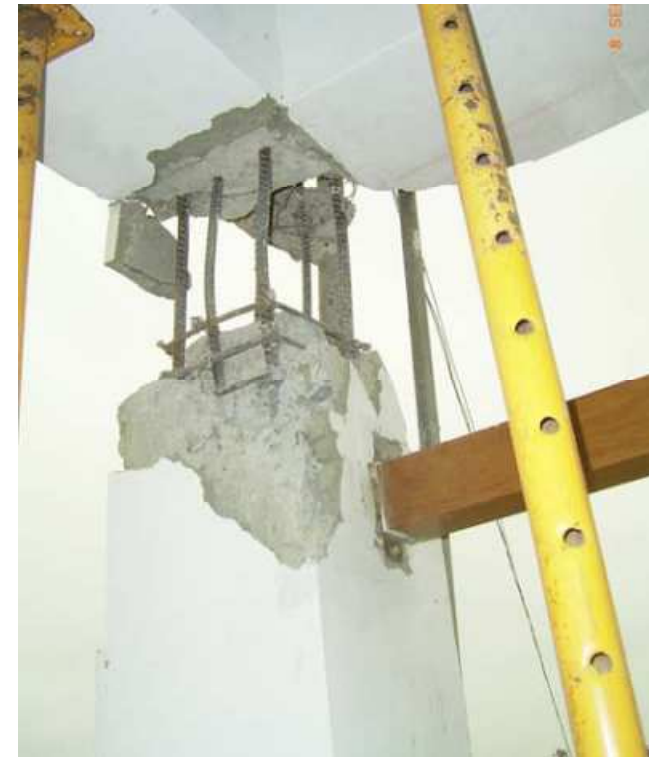
Cedarea stâlpului la nodul superior din lipsă de etrieri și activarea mecanismului grindă puternică – stâlp slab
