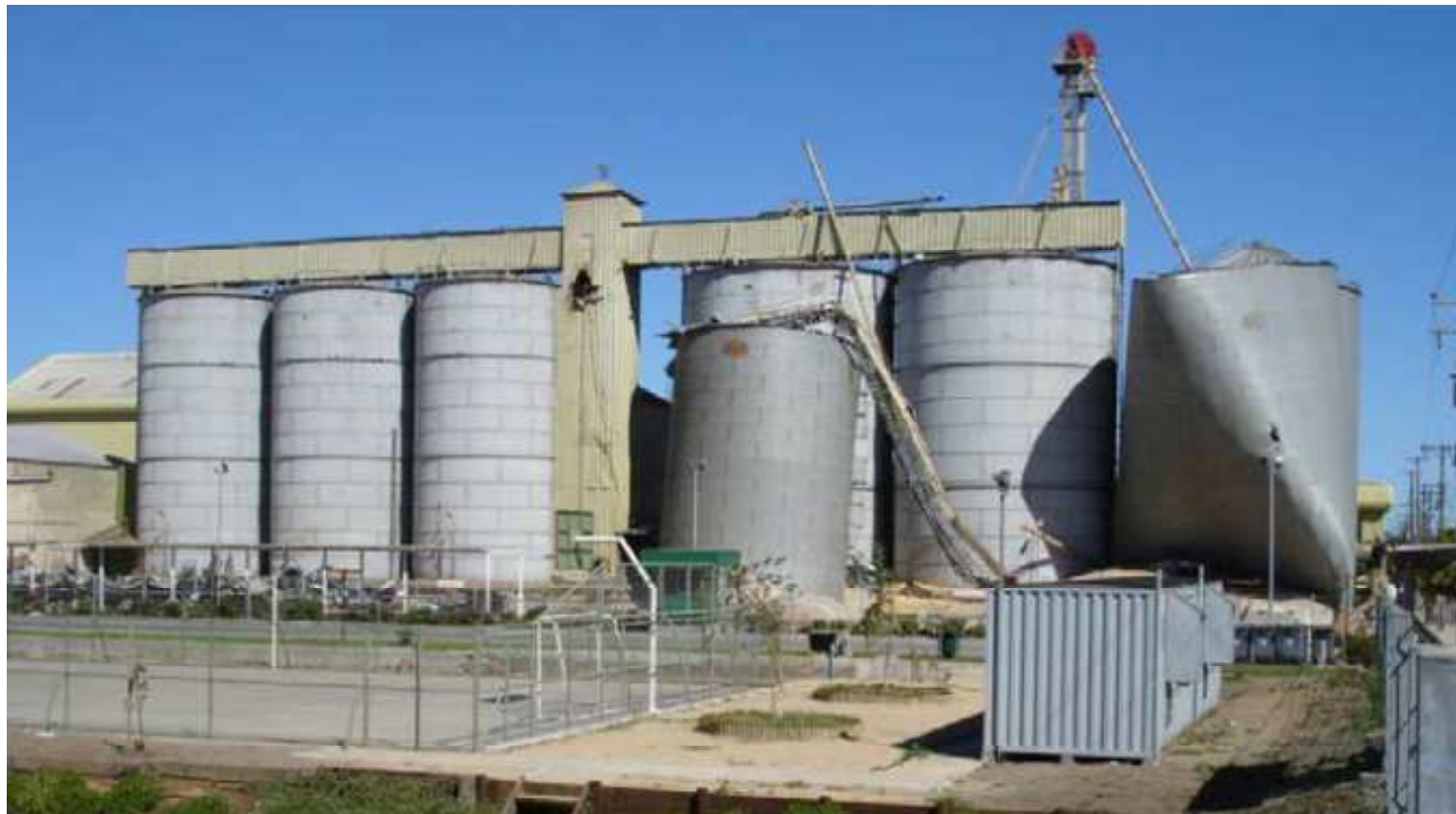
Silozuri cu deplasări blocate – nedeteriorate. Flambajul silozului izolat
