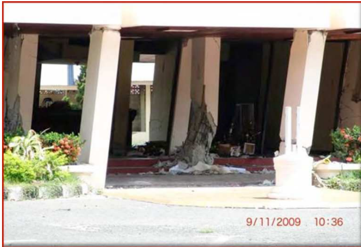
Colapsul parterului flexibil
