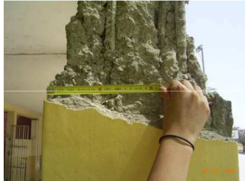
Acoperire cu beton excesivă care reduce capacitatea portantă la încovoiere, și calitate redusă a betonului
